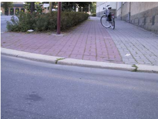
Bild 5-5: nur vereinzelte Radwegabschnitte, z.T. baulich Mängel (hier: hohe Bordkante)
